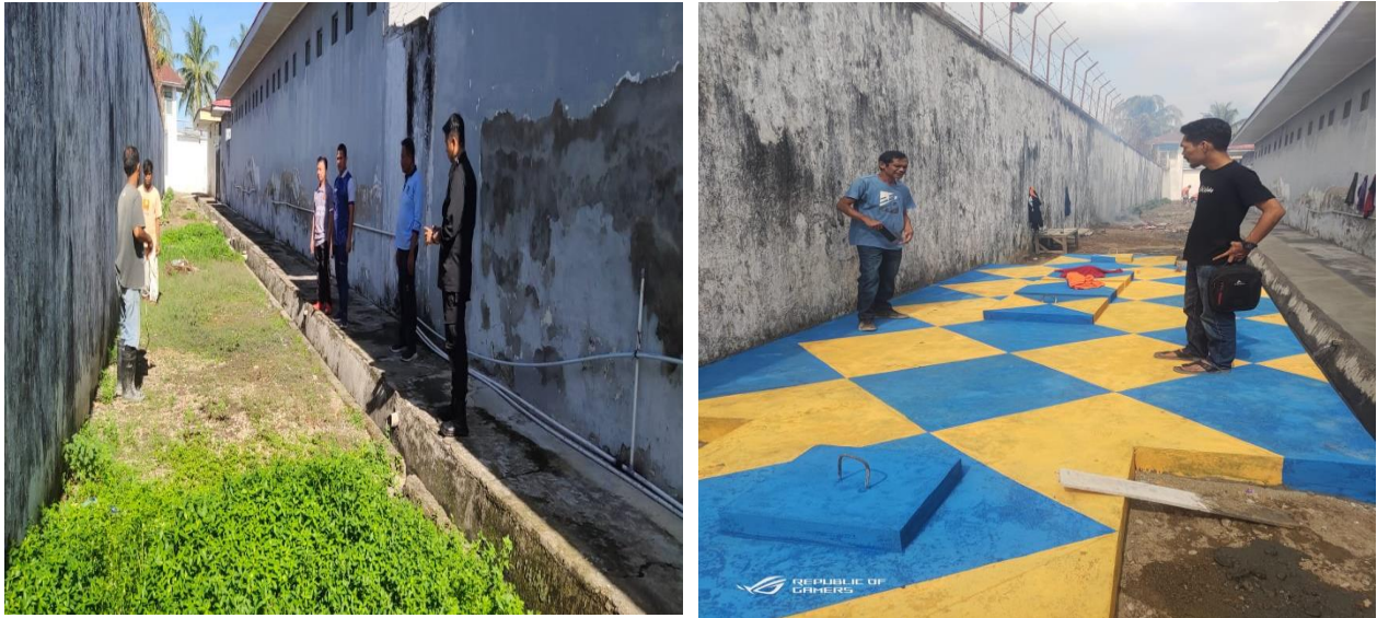
Gambar 12. Dokumentasi Kegiatan Pembangunan Sarana dan Prasarana Sanitasi Lapas Polewali
